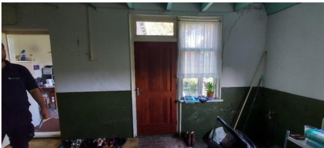
afb. 41 De werkruimte op de bovenste foto de linkerwand en achterwand met in de hoek de ingebouwde sanitaire ruimte, de middelste foto de achterwand met de deur naar de grup en rechter zijwand waartegen de stookplaats met rechts daarnaast de deur naar de dwarsgang en onder de voorwand met links de deur naar de keuken en rechts de deur met zijlicht
