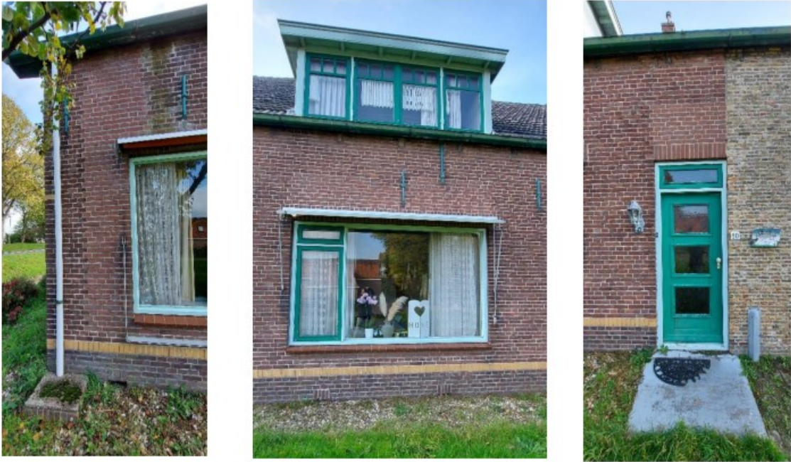
afb. 18 Verstoringen in het metselwerk, onder meer ten gevolge van de vervanging van de vensters en de deur
